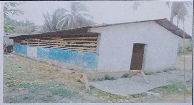
Foto 2: Se observa el deterioro de los valcones, pintura de la pared, puerta y piso del corredor del modulo1
