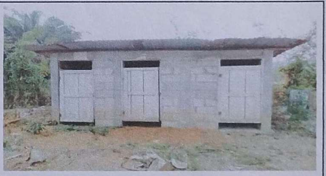
Foto 4: Se observa el deterioro del techo, pintura y puertas del baño del modulo 2.
