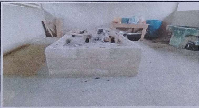
Foto 3: Se observa el deterioro del piso del piso y polleton de la cocina del modulo 1.
